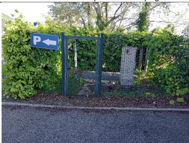
8- Station de relevage EU – Sud-ouest
