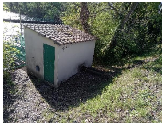
St-pomp - Station de pompage pour la cimenterie LAFARGE – vue depuis l'Avenue de Provence
