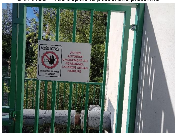
St-pomp - Station de pompage pour la cimenterie LAFARGE – Accès interdit
