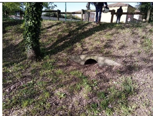
REJET – rejet eaux de voirie (conduite obstruée ?) proche WC publics – Ouest du Lac
