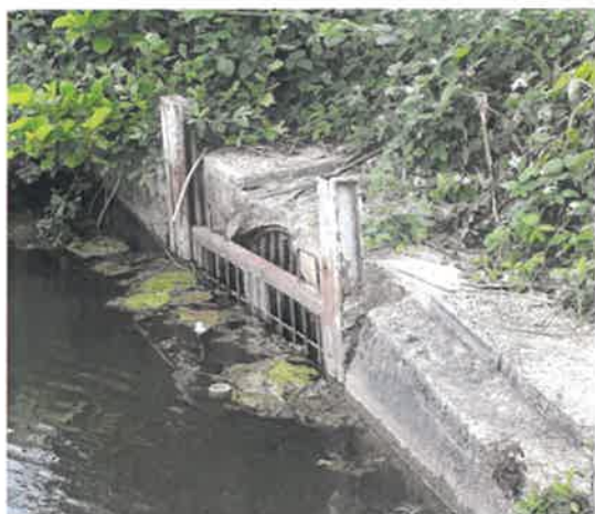
Vanne de régulation du niveau de l'eau (Source : IRH IC)
