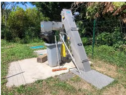
Vue sur le poste de dégrillage
