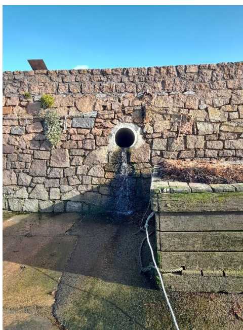
Figure 36 : Photo de l'exutoire pluvial situé près du poste de refoulement de Bellevue. Source LTC 2024
