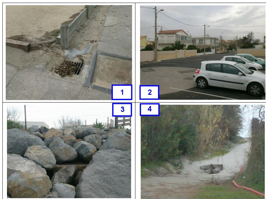
Figure 43 Photographies des rejets d'eaux pluviales (2010)
