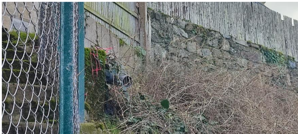
Figure 24 : Prise de vue d'un exutoire d'eaux pluviales débouchant en haut de falaise
