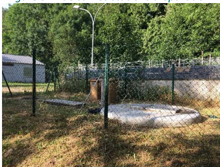
Vue sur le poste de relevage STEP
