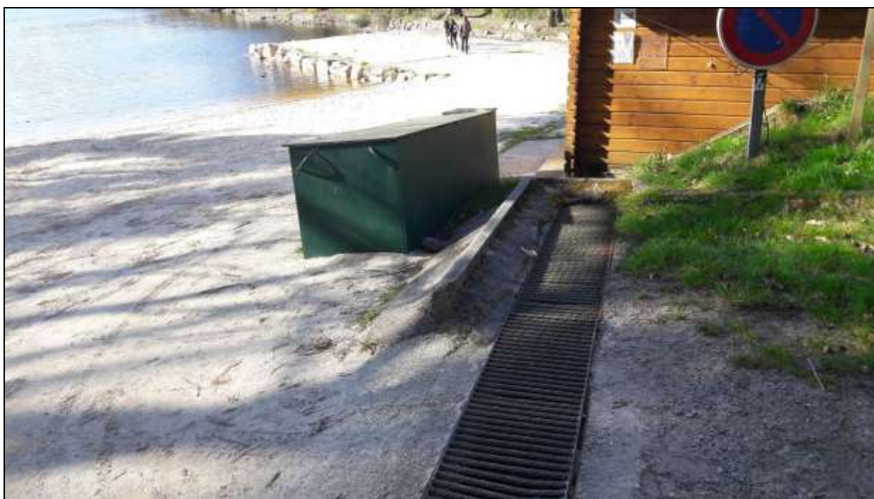
Fig. 15 : Avaloir assurant la collecte des eaux pluviales de la voirie permettant l'accès à la plage
