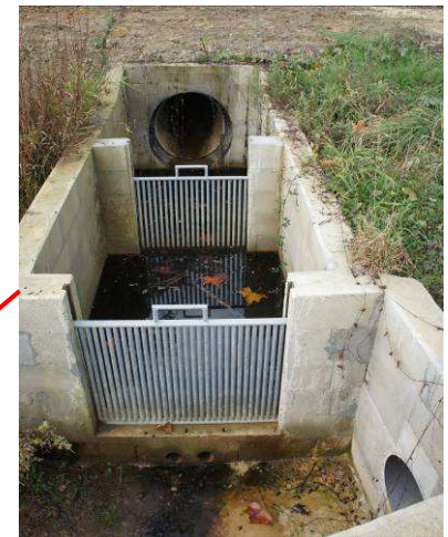
Exutoire de vidange
