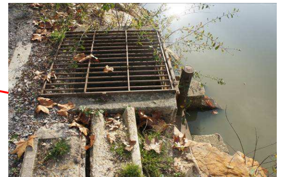
Vanne de vidange située en milieu de digue
