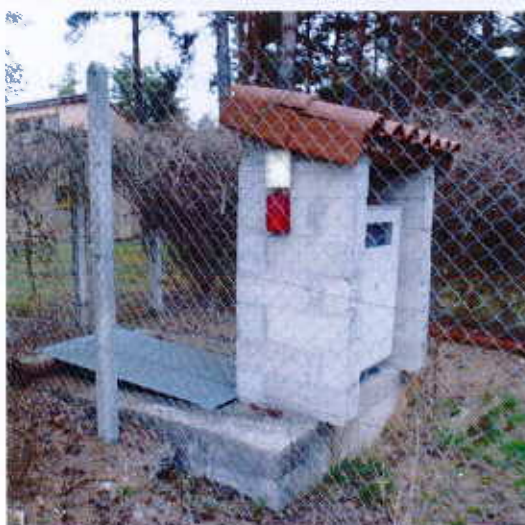
Figure 41 : Photographie du poste de refoulement du camping (Source : ATHOS Environnement 2012)
