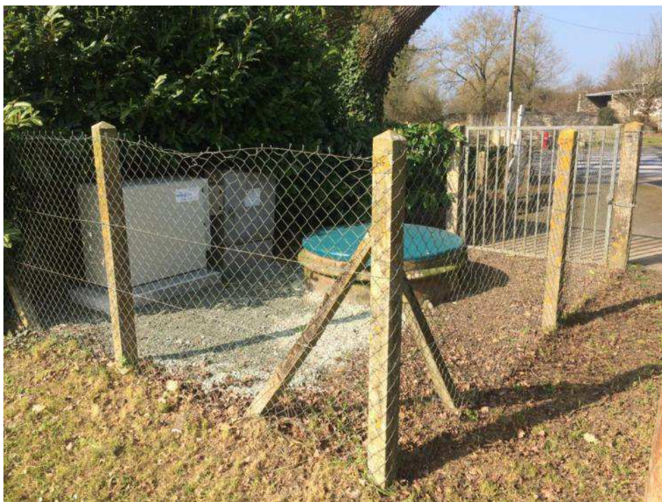
Figure 25 : Poste de refoulement du Buhel
