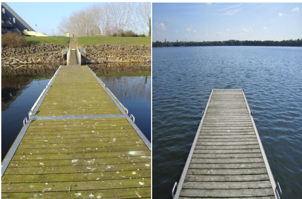
Pontons avant nettoyage (février), après nettoyage (aout)
