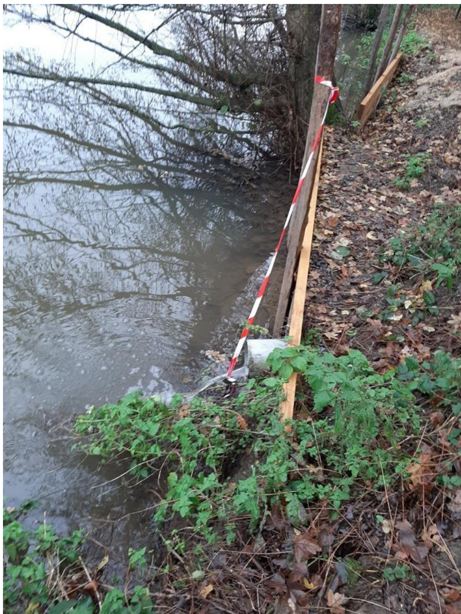
Figure 40 : Vue d'un rejet d'eau pluviale dans le barrage de Coulvée -rive droite en aval de l'exploitation Agricole de la Halbaudière
