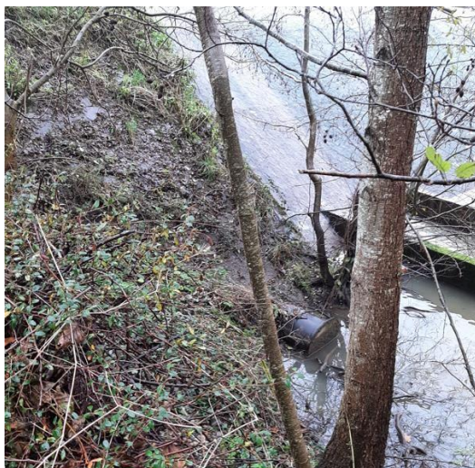
Figure 19 : Arrivée de la conduite de vidange en pied de barrage
