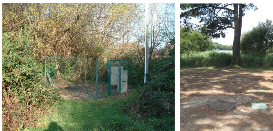
Figure n°34 : Poste de relèvement de Kernevest (à gauche) et du fort (à droite)
