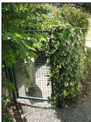
Figure n°59 : Poste de relèvement de Men-er-Beleg 2
