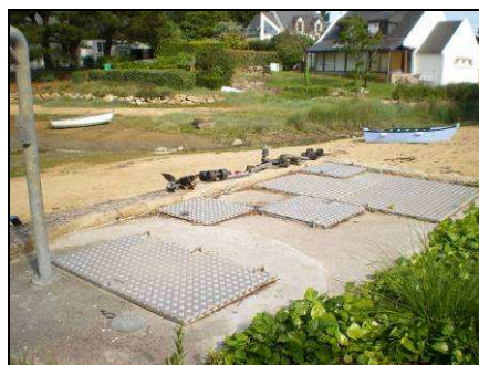
Figure 68 : Poste de relèvement de Mané-Jouan
