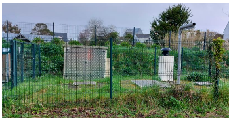
Figure 20 : Poste de relèvement situé sur le parking de la plage – 2024
