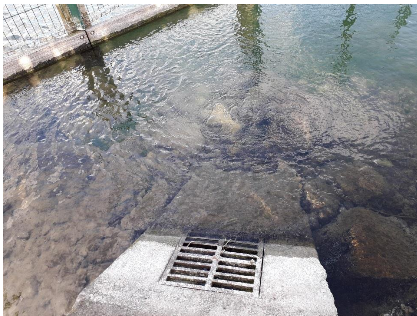
Photo 4 : Exutoire du système de drainage des résurgences situé sous le sable de la plage (2019)
