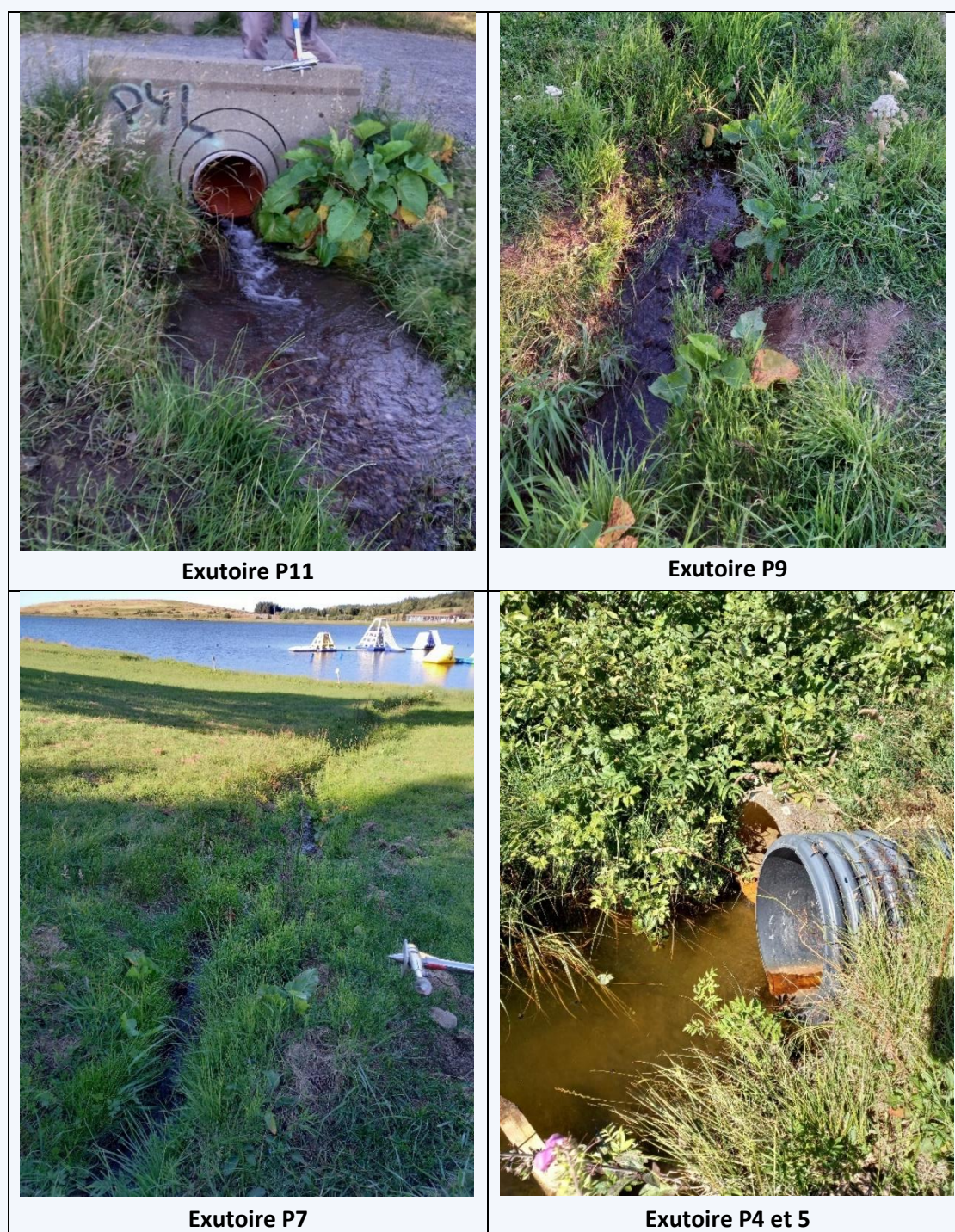
Figure 84 : Exemples d'exutoires pluviaux débouchant dans le lac (Source : ATHOS Environnement, 2022)
