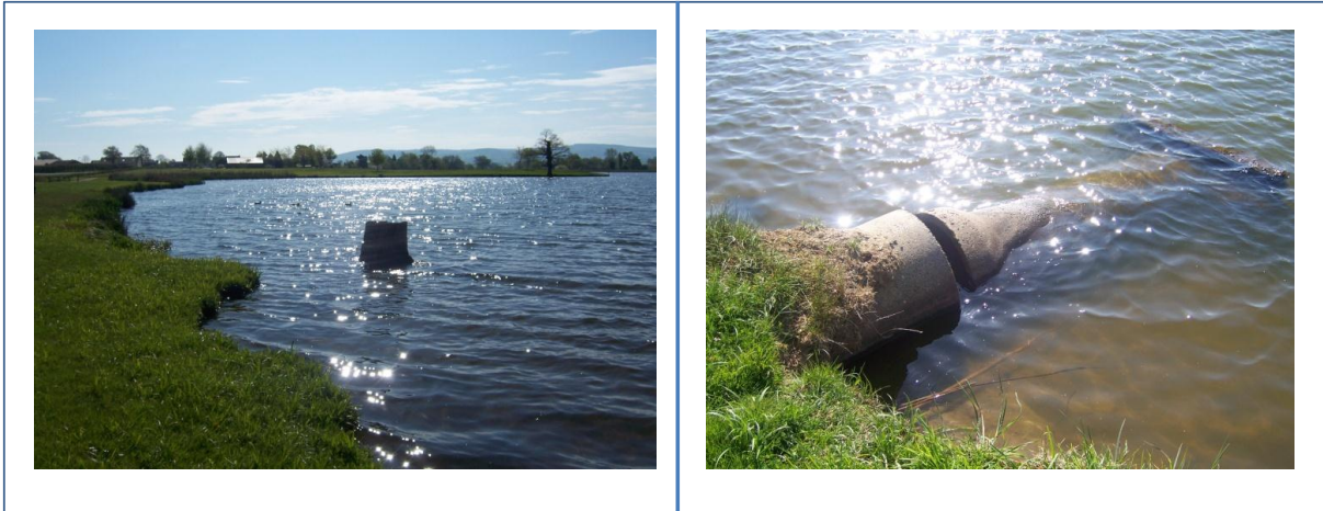
Photographie 3 : buse effondrée du ruisseau d'alimentation nord, souche éloignée de la berge (sources : ATHOS Environnement)
