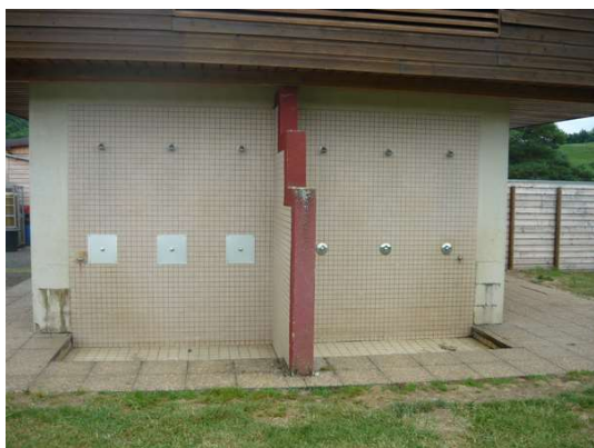
Illustration 7 : Vue des douches extérieures (crédit photo : géonat)
