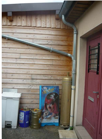
Illustration 21 : Collecte des eaux pluviales des installations du site de baignade (Crédit photo : Géonat)
