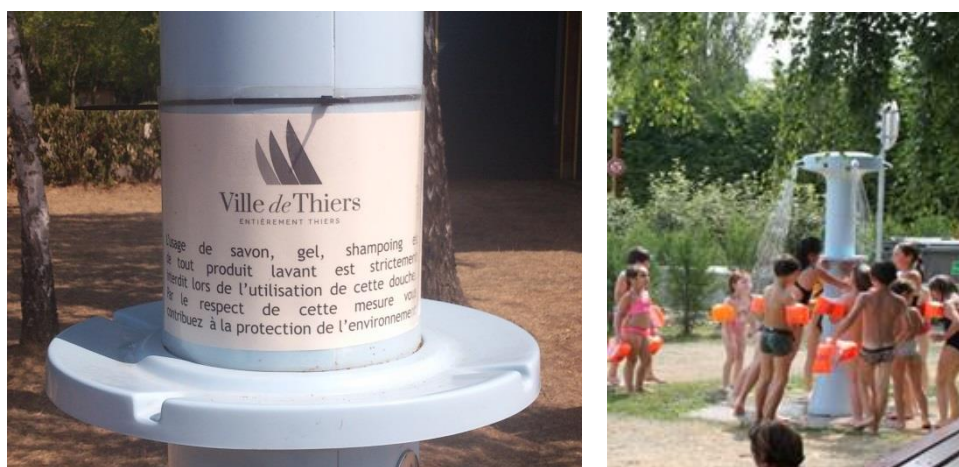
Figure 3 : Aménagement de douche sur la plage (Source : Mairie de THIERS)
