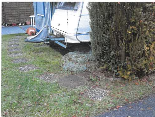
Figure 20 : branchement des emplacements
