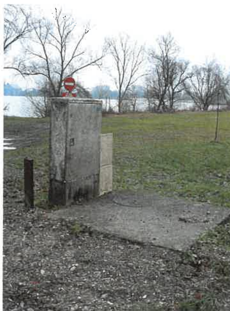
Figure 21 : Poste de relevage en aval du secteur
