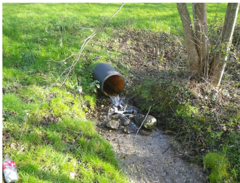
Figure 33 : Rejet au lac, en rive est, mêlant eaux pluviales et eaux de source (Source : photo CIDEE)
