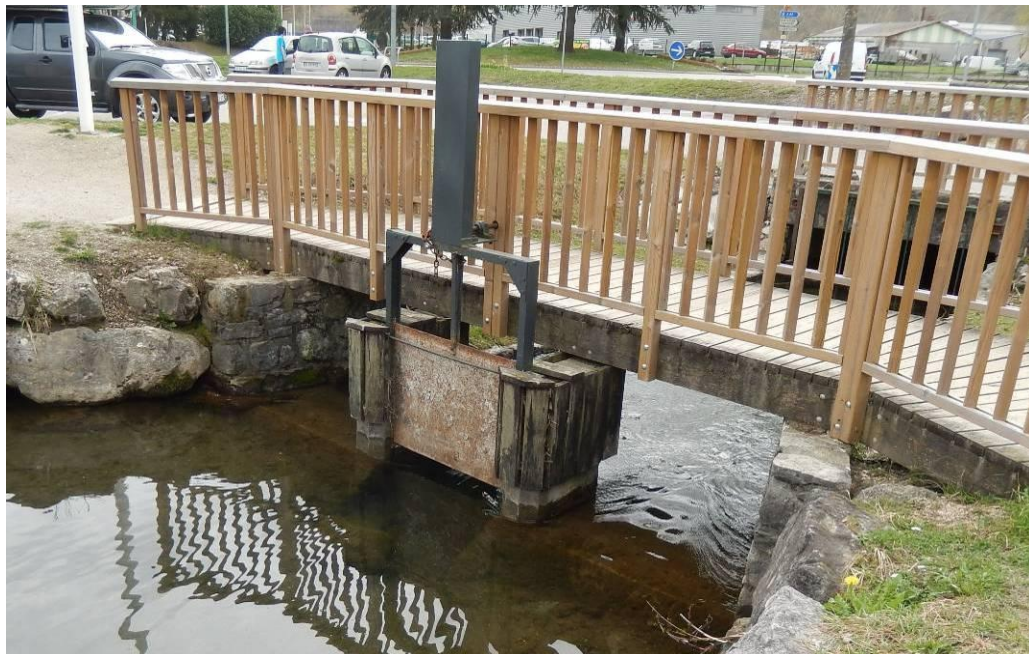
Figure 11 : vanne au niveau de l'exutoire du lac
