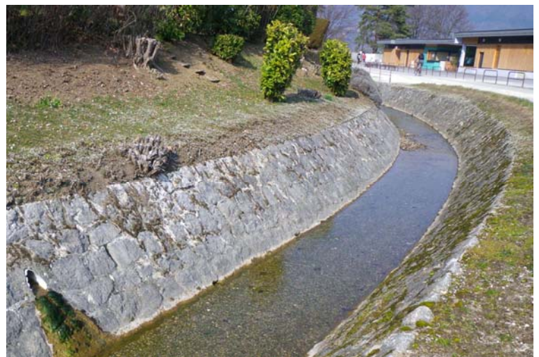
Figure 21 : Ruisseau de la Combe dans sa partie aval s'écoulant dans un lit bétonné de forme trapézoïdale (08/03/2011)
