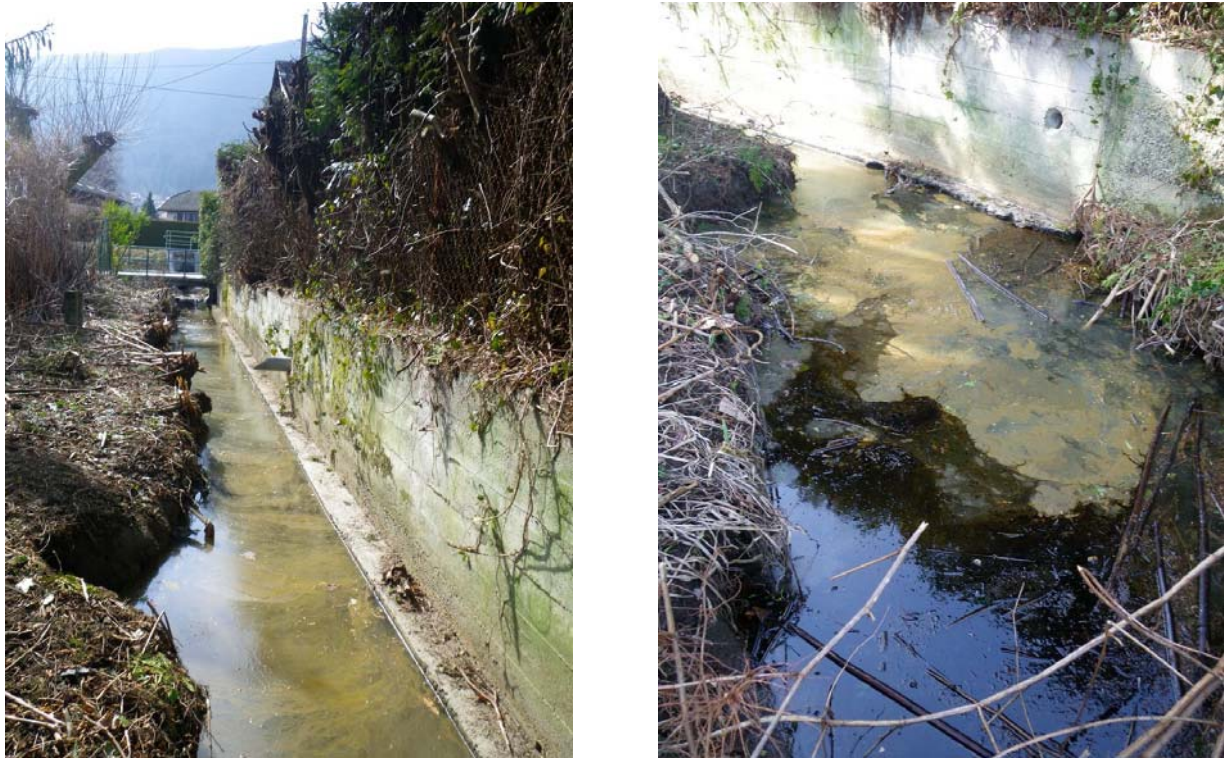
Figure 25 : Exutoire visuellement dégradé entre le port et la plage du Clos Berthet (10/03/2011)
