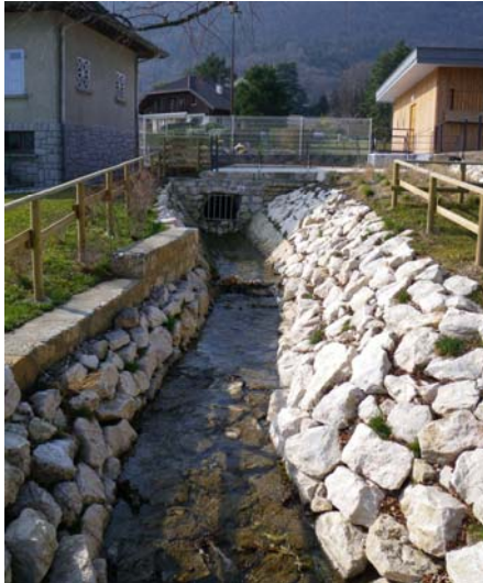
Figure 22 : Partie aval du ruisseau de la Combe remise à ciel ouvert en 2009-2010 (08/03/2011)
