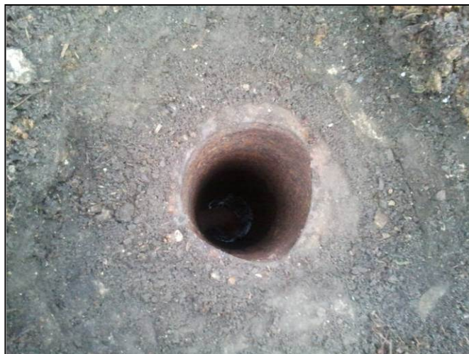
Photo 9 : Forage situé Impasse du lac (profondeur -1,10 m)
