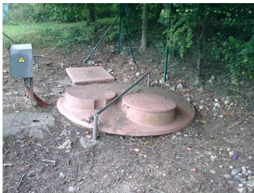
Photo 11 : Poste de refoulement du site de Caniel
