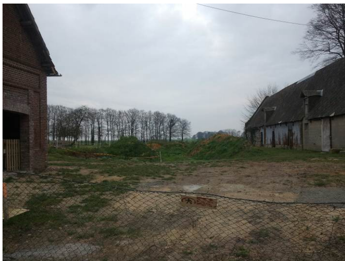
Photo 28 : Effondrement non déterminé au hameau de Bardeville
