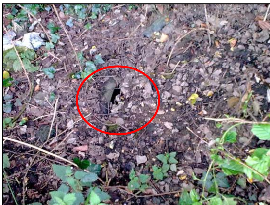
Photo 20 : Bouchage de l'exutoire du fossé pluvial du parking principal
