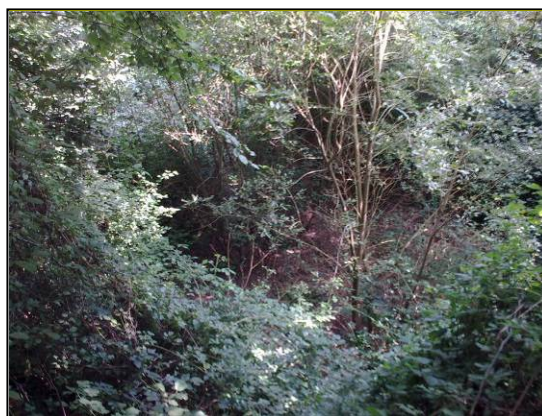
Photo 15 : Bassin pluvial hors d'usage envahi par la végétation – secteur de la piste de luge
