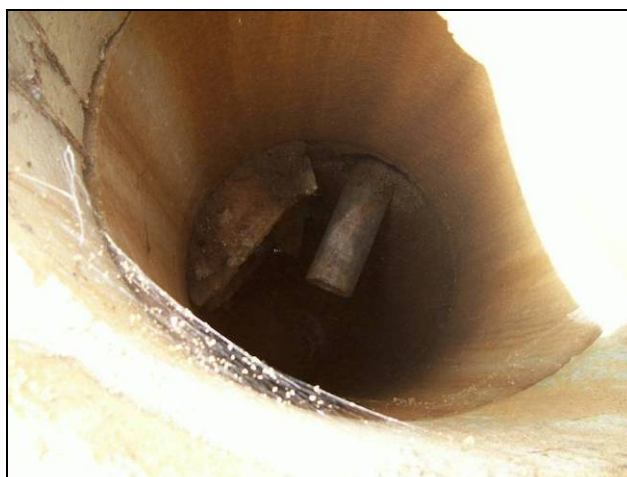
Photo 10 : Puits filtrant exutoire de la station d'épuration d'Ouainville
