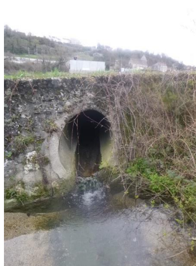
Rejet du bassin dans le fossé communal
