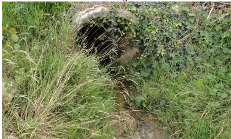
Figure 3 : Photographie de la buse d'évacuation des eaux du lac de baignade © ETEN Environnement
