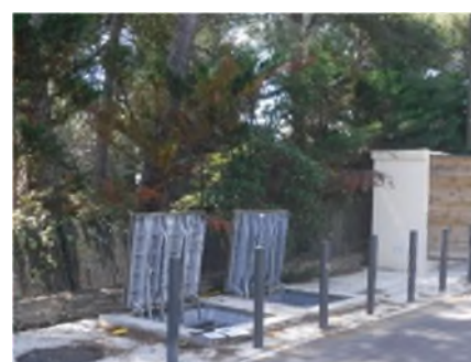
Vue sur le nouveau poste de relevage Beauvallon
