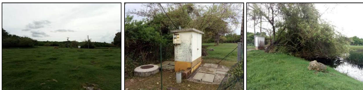
Figure 14 : Poste de refoulement de tête de la station d'épuration - Photos du site
