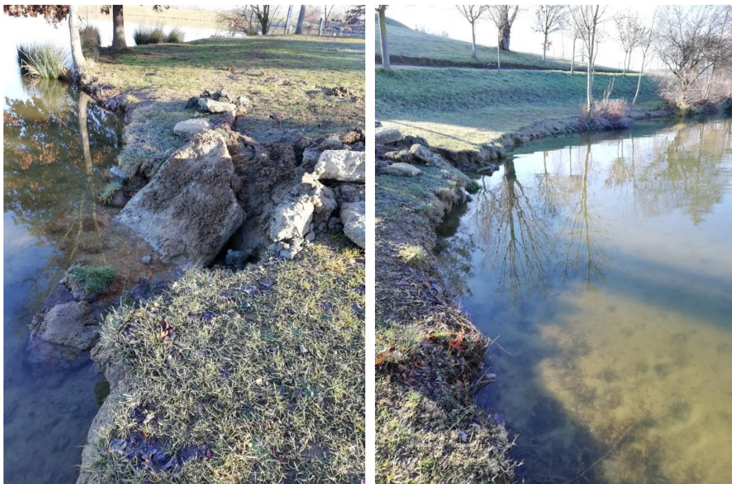
Erosion des berges : présence de blocs de bétons
