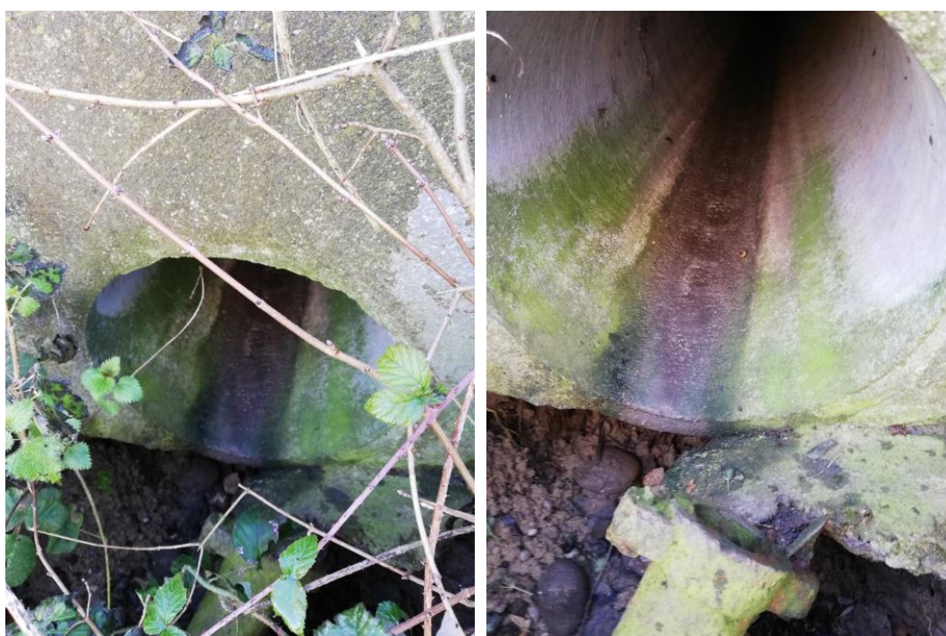
Aspect de la buse : écoulement probable
