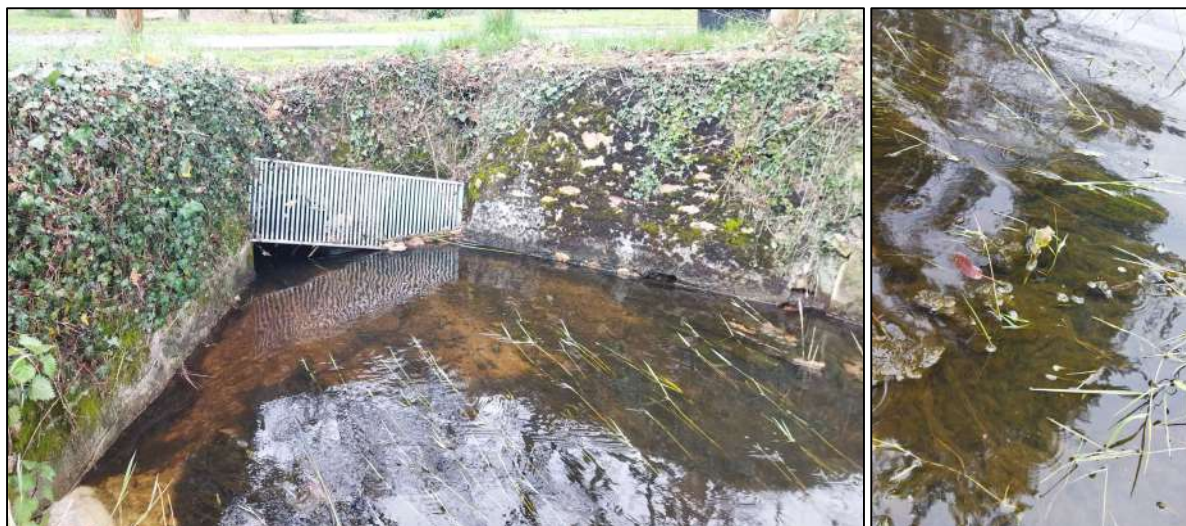
Figure 21 : Accumulation d'algues devant l'ouvrage de sortie n°3, vue générale (à gauche) et zoom (à droite)
