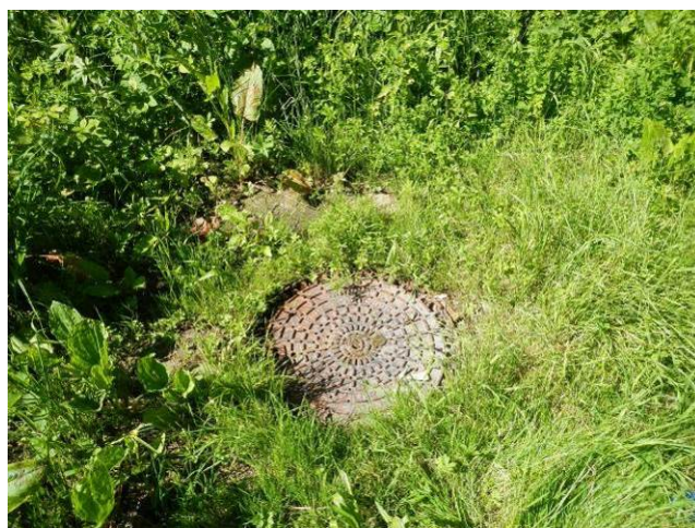
Regard de la fosse septique
