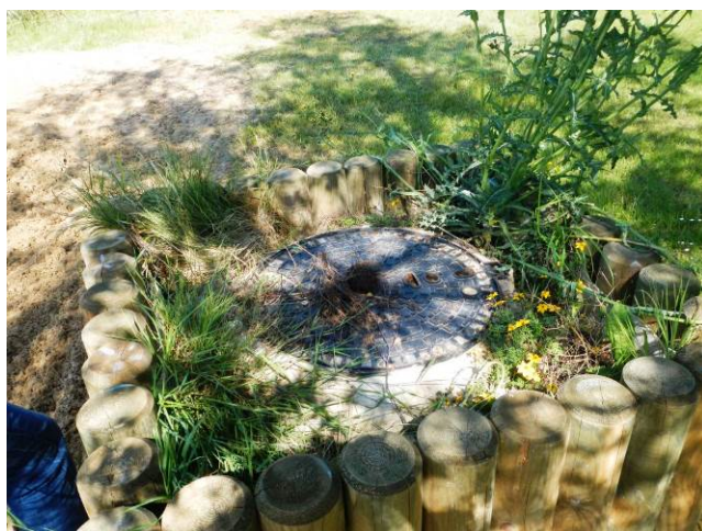
Regard de la canalisation acheminant les eaux usées vers la fosse septique
